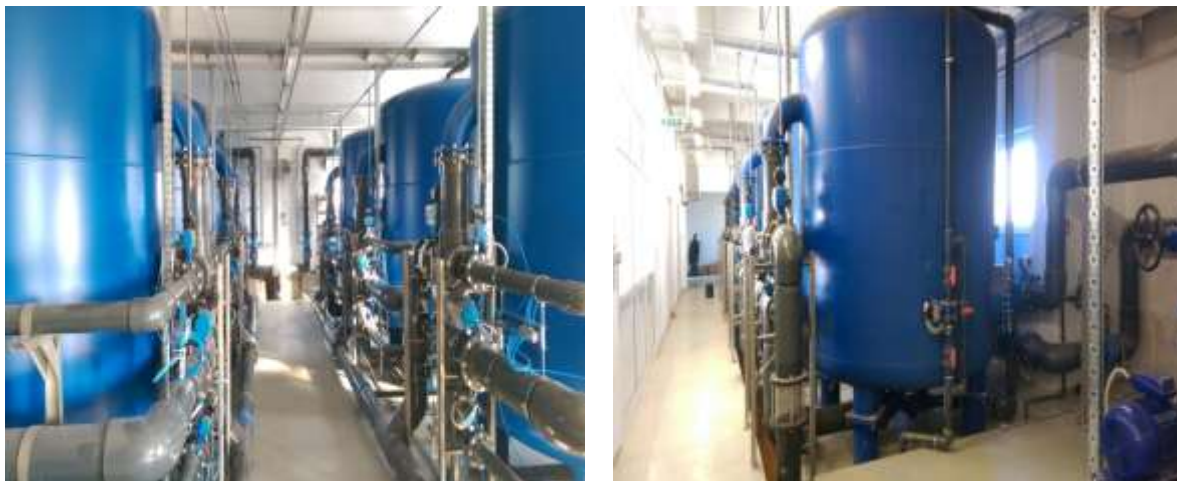
Slika 2.3 Stari (obnovljeni) i novi pogon obrade vode na crpilištu Velimirovac
